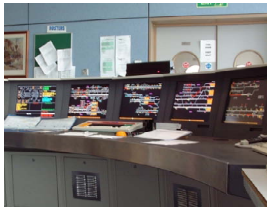
Sala de control.
